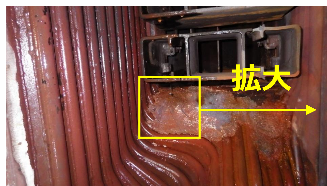
ボイラ蒸発管
