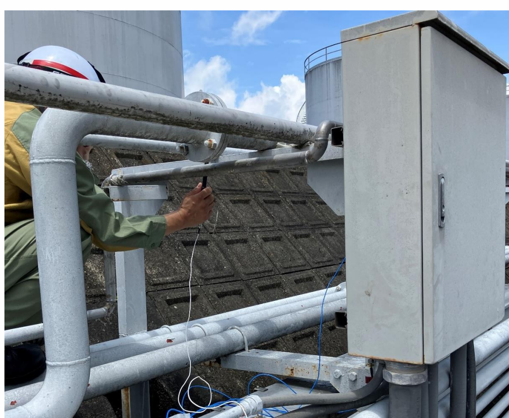
図8 アルコール配管
